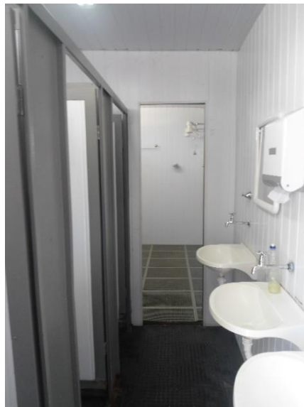
Figura 3 - Instalação sanitária do projeto piloto de uma usina.
