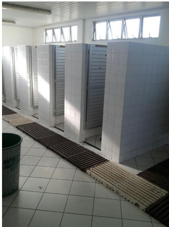
Figura 32 - Instalação sanitária do canteiro das contratadas de uma distribuidora de petróleo.
