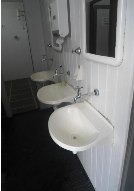
Figura 5 - Área de lavatório do projeto piloto de uma usina.
