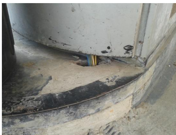
Figura 10: Auto Posto X, em Aracaju, uso de ponto de força com a fiação exposta.
