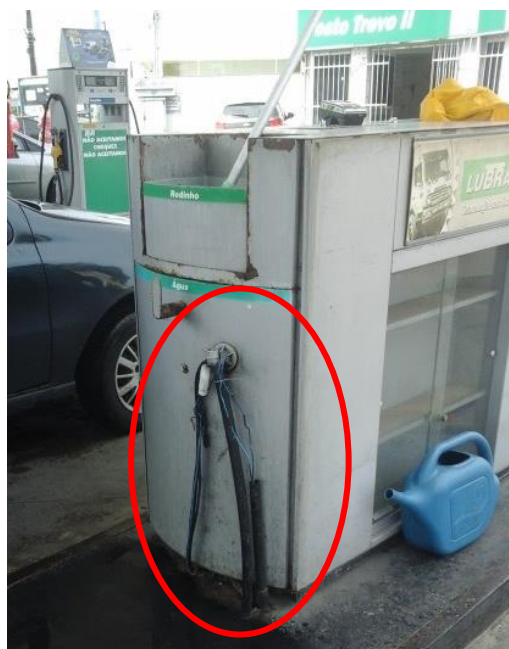
Figura 8: Auto Posto Y, em Aracaju, uso de tomada comum e com fiação exposta.
