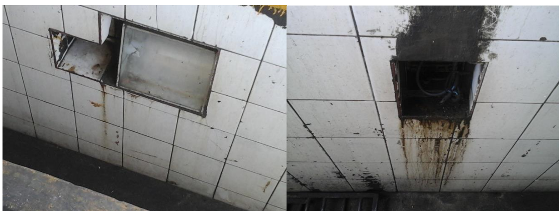
Figura 12: Auto Posto Z, em São Cristóvão, iluminação do dique de troca de óleo.
