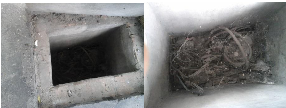
Figura 6: Auto Posto Y, em Aracaju, com caixa de passagem sem a proteção e com a fiação exposta, podendo gerar centelhamento em zona 2 de classificação.
