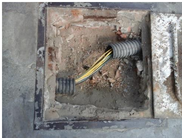
Figura 5: Auto Posto X, em Aracaju, com caixa de passagem sem a proteção e sem o invólucro com proteção aumentada.
