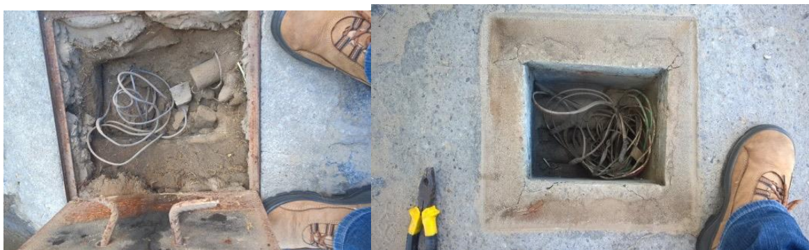
Figura 7: Auto Posto W, em São Cristóvão, com caixa de passagem sem a proteção e com a fiação exposta, podendo gerar centelhamento em zona 2 de classificação.
