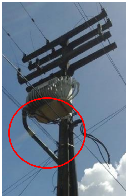
Figura 1: Entrada de fornecimento de energia, posto Z, em São Cristóvão.
