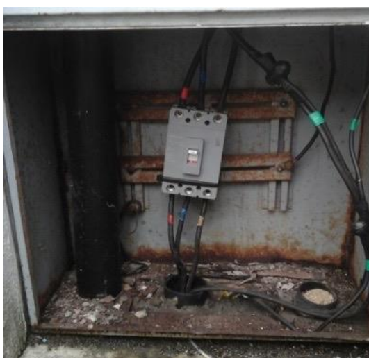
Figura 3: Disjuntor geral sem a fixação no quadro no Posto Y, em Aracaju.
