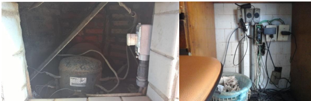
Figura 9: Auto Posto Z, em São Cristóvão, uso de tomada comum em área classificada.
