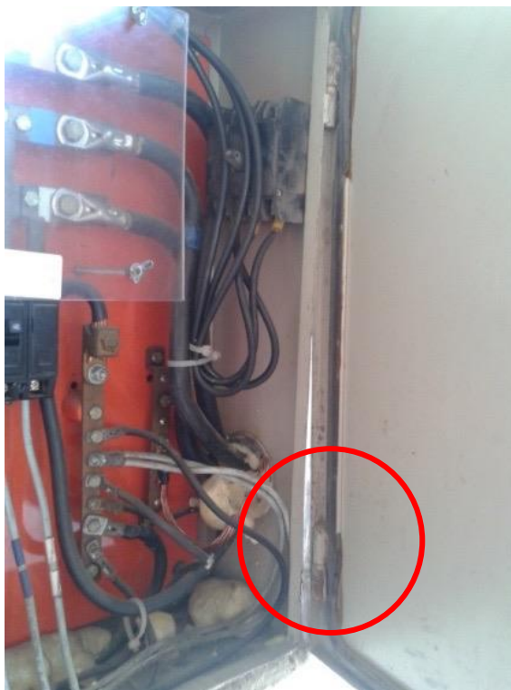
Figura 2: Dobradiça da porta quebrada no Posto X, em São Cristóvão.
