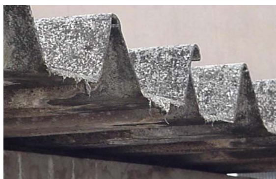
Figura 7: Telhas de cimento-amianto antigas são um grande perigo ao meio ambiente.
