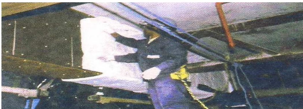
Figura 16 – Aplicação da Manta composta por Fibra Cerâmica na Estrutura de Aço (DIAS, 2002, [n.p.] )
