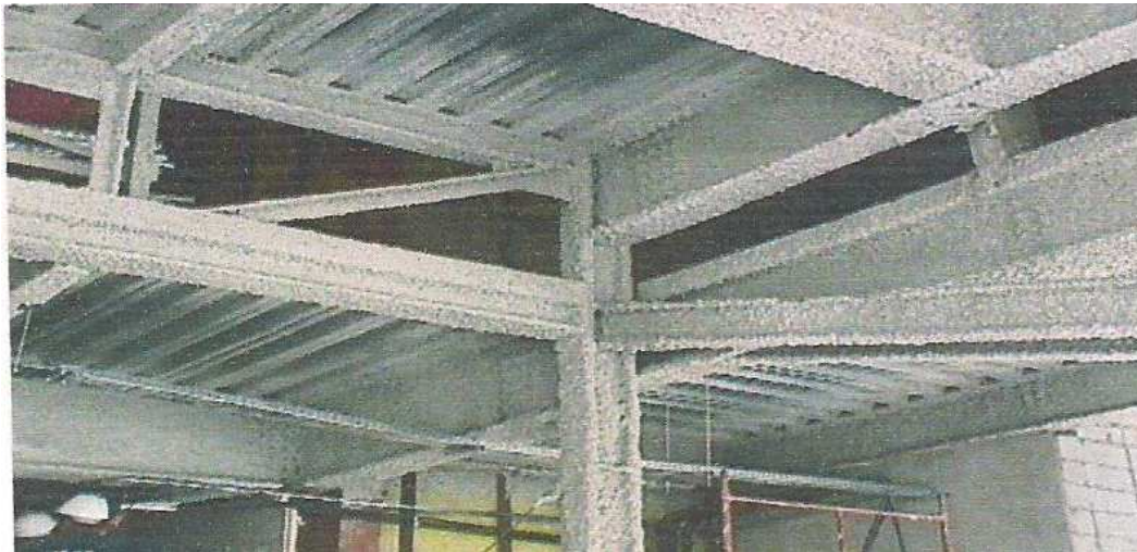
Figura 2- Acabamento da Estrutura após jateamento, aparentando chapisco
