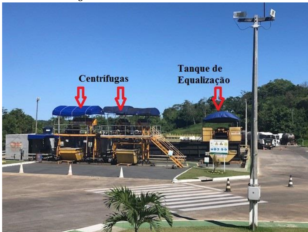
Figura 19 - Unidade de tratamento de fluidos
