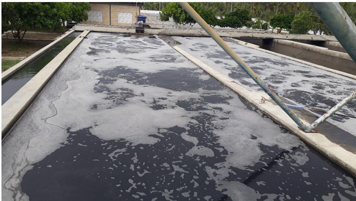
Figura 8 – Valos de aeração ou tanques de oxidação
