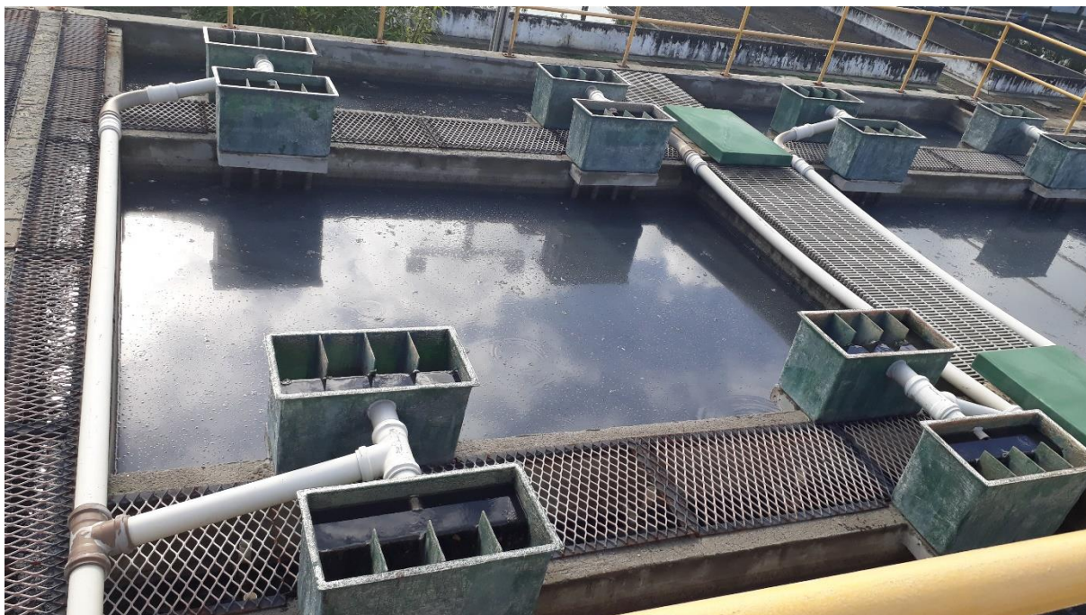
Figura 7 – Sistema DAFA empregado no tratamento de efluentes
