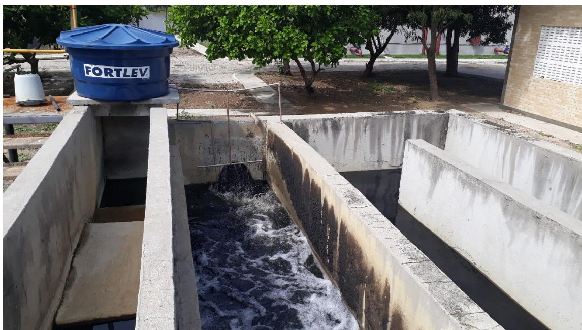
Figura 10 – Tanque de contato localizado numa ETE
