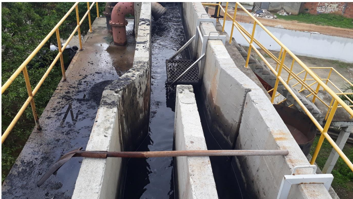
Figura 5 – Caixa de areia de uma estação de tratamento de esgoto
