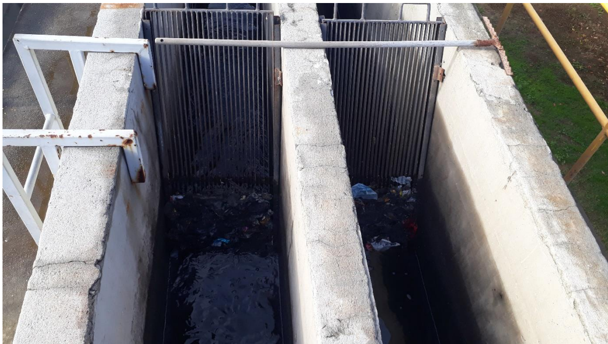
Figura 4 – Etapa de gradeamento de esgoto numa estação de tratamento
