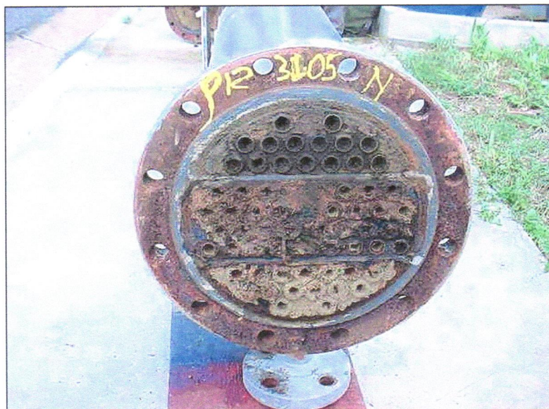
Figura 18 – Obstrução nos tubos devido a depósito biológico no resfriador de LGN
