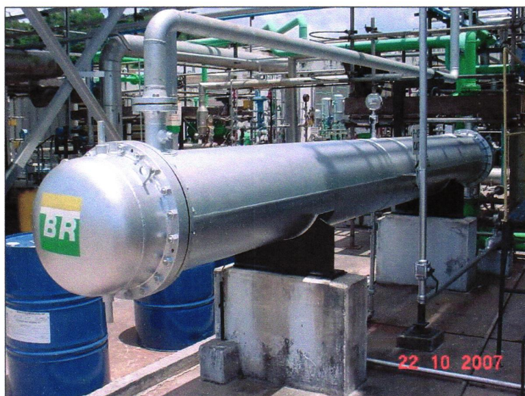
Figura 16 – Permutador de calor P-123109
