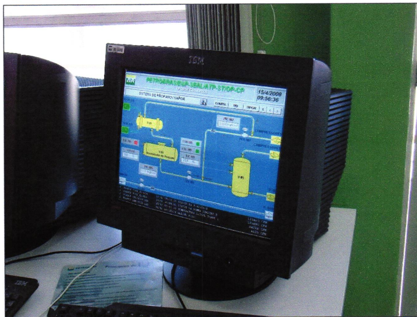
Figura 11 – Supervisório da Sala de Controle da UPGN-CP
