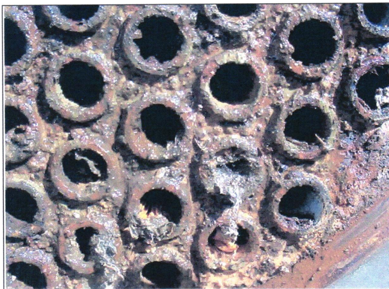
Figura 17 – Detalhe de depósito biológico e incrustação nos tubos do P-123109
