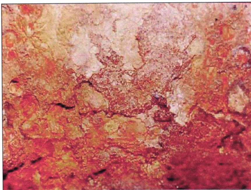
Figura 4 – Corrosão uniforme em chapa de aço carbono (GENTIL, 2003, p. 42)
