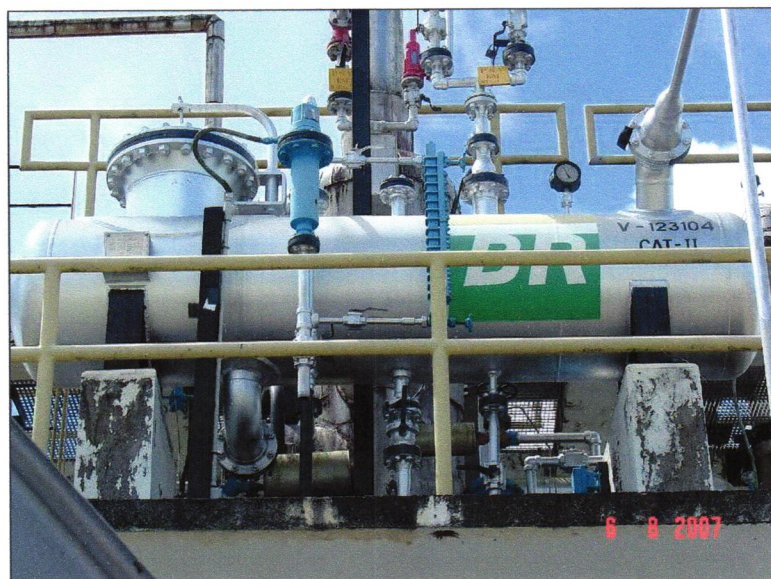
Figura 24 –Vaso acumulador de propano V-123104
