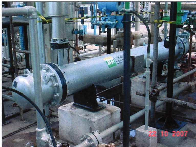
Figura 15 – Permutador de calor P-123105
