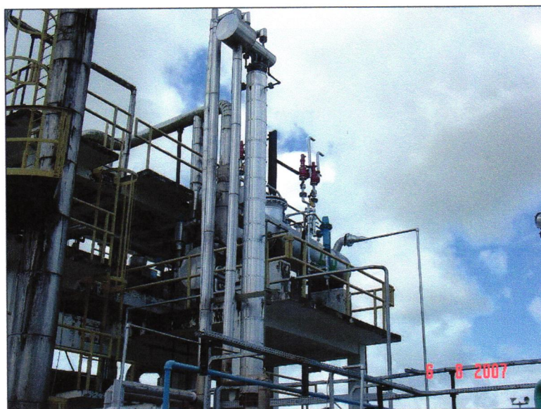
Figura 28 – Torre regeneradora de glicol: T-123102
