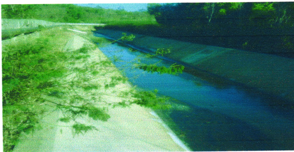
Figura 25 – Vegetação abundante na região do canal de tratamento após sua impermeabilização. Fonte – Vale (2009)
