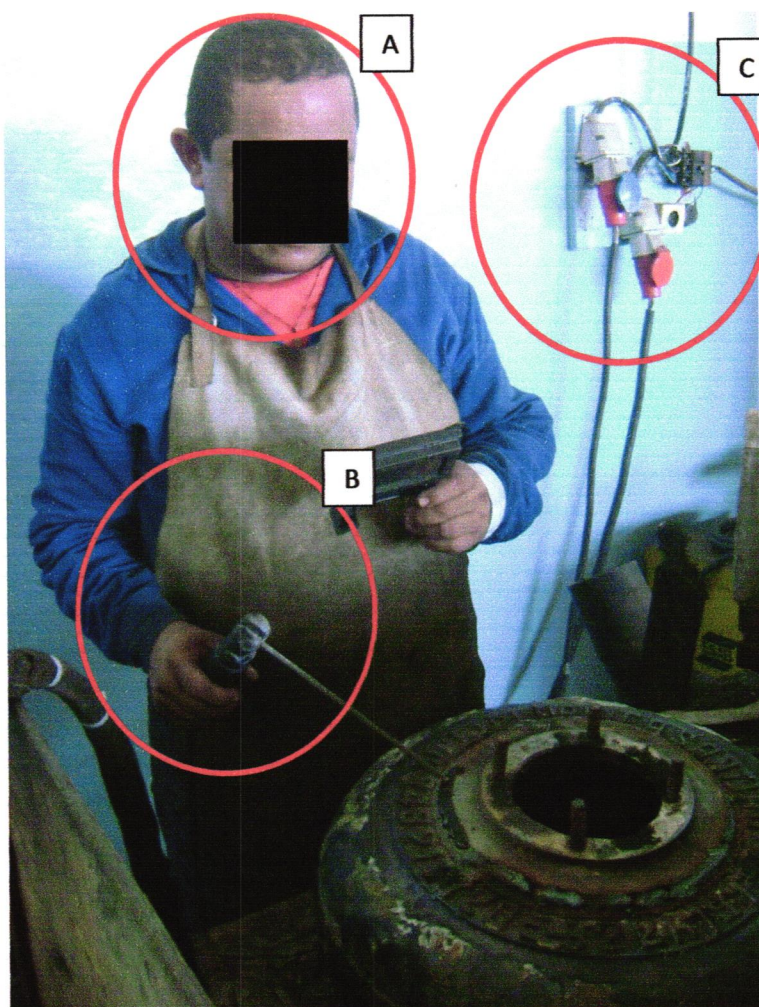
Foto 01 – Trabalhador realizando solda sem EPIs
