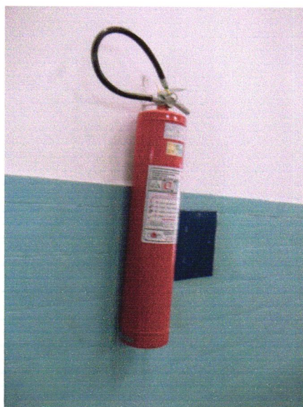
Foto 20 – Extintores de incêndio novos
