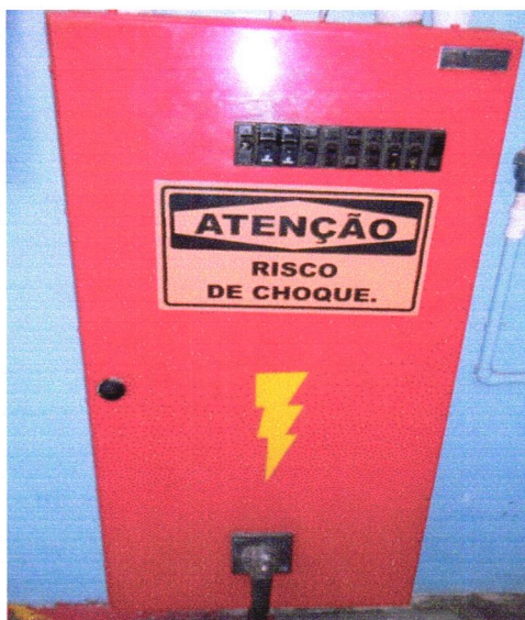
Foto 21 – Avisos de risco de choque
