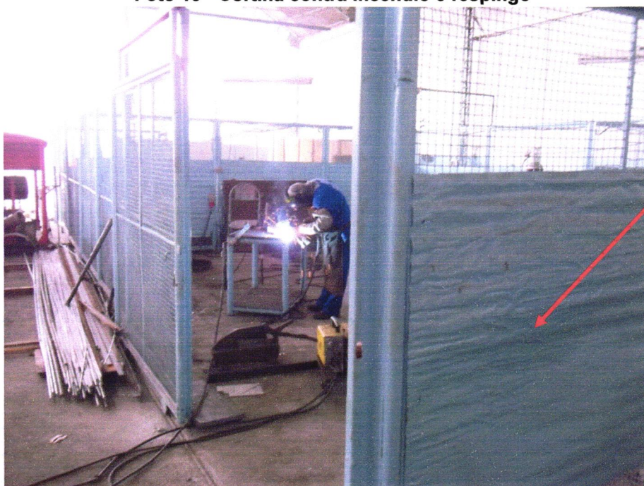
Foto 13- Cortina contra incêndio e respingo
