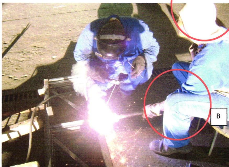
Foto 08 – Falta de uso de perneiras
