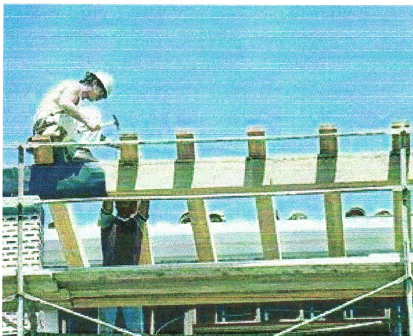
Figura 13: Não está usado todos os EPI'S necessários.
