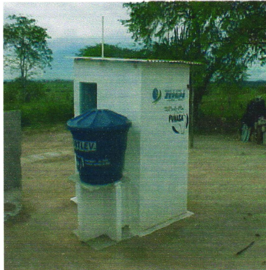
Foto 06 – Vista de um banheiro na zona rural que não dispõe de abastecimento de água em Porto da Folha (na época da entrega ao beneficiário).
