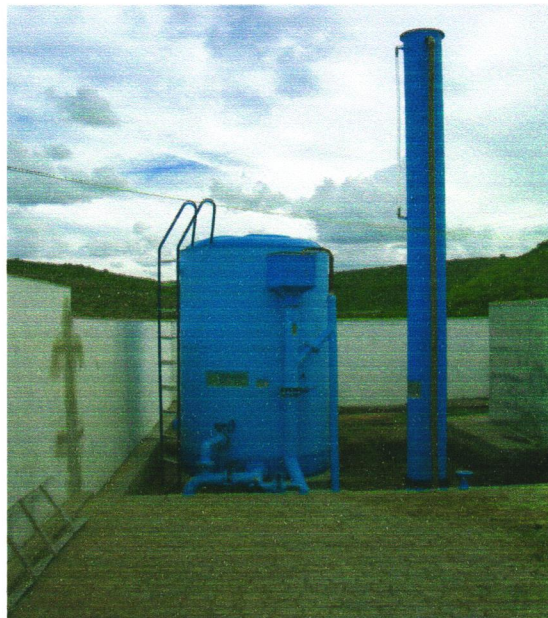
Foto 02 – Vista do Filtro de Fluxo Ascendente – ETA
