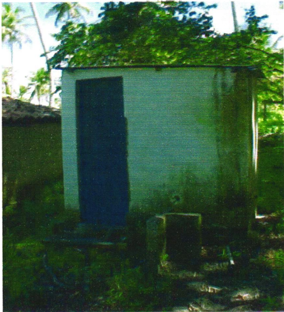
Foto 07 – Vista de um banheiro na zona rural em péssimo estado de conservação / abandonado.
