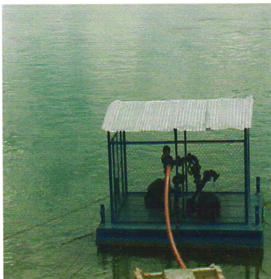
Foto 01 – Vista da captação com Flutuante no rio São Francisco.
