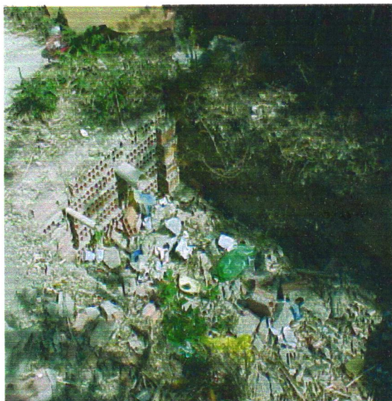
Foto 09 – Elemento construtivo (sumidouro) destruído pelo beneficiário em pouco tempo.
