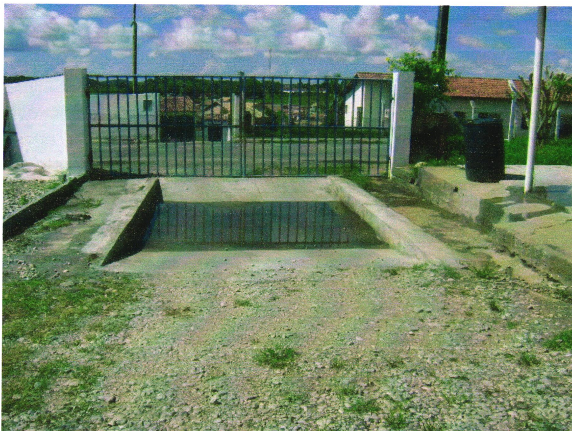
Foto 2: Calha de descontaminação de veículos
