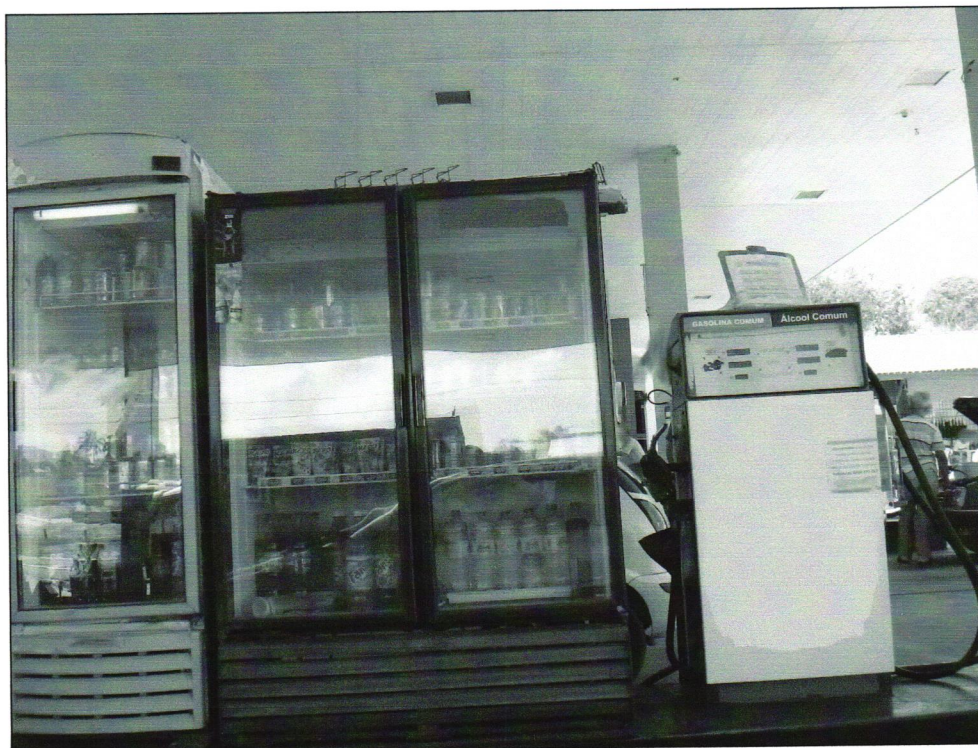
Figura 43 – Localização irregular de freezers em área de classificação Zona 2.
