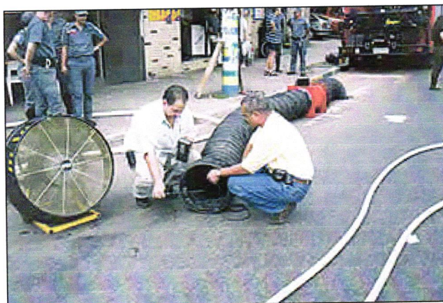
Figura 20 - Exaustão de vapores inflamáveis em galeria subterrânea de esgotos.
