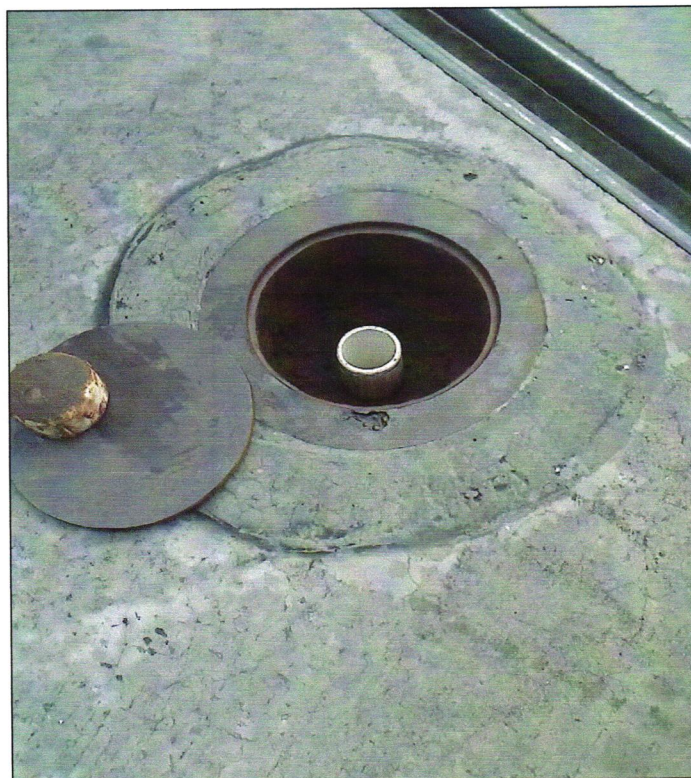
Figura 23 - Poço de monitoramento.
