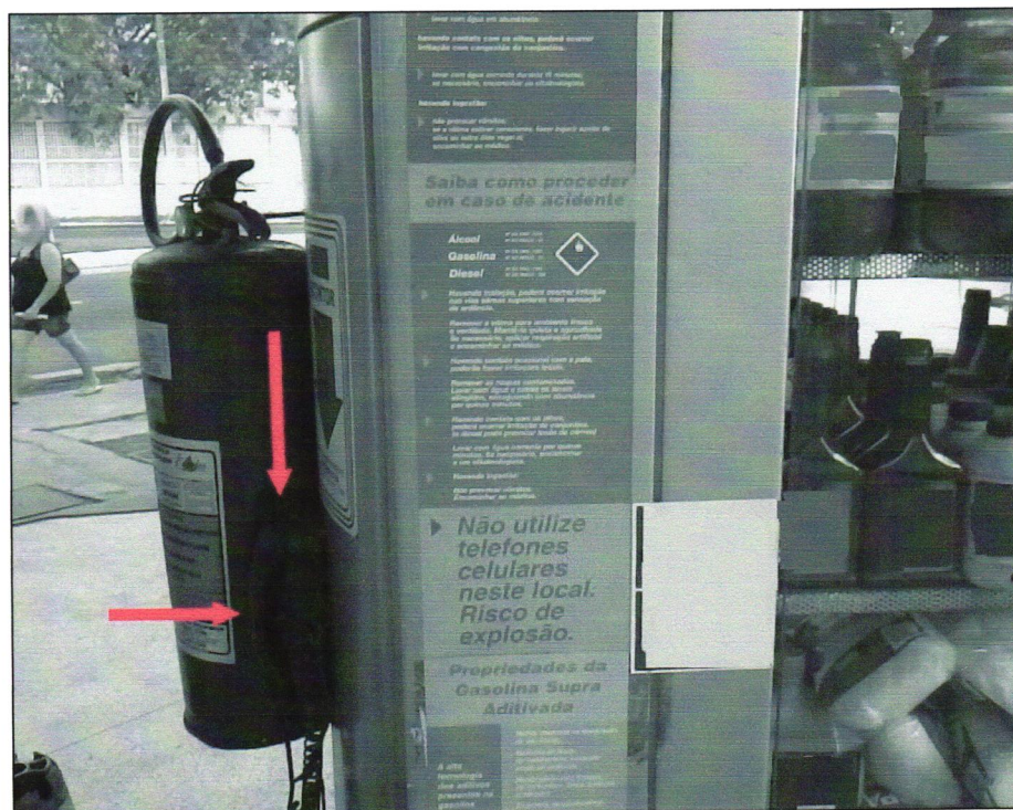
Figura 40 – Telefone (ver setas) sem proteção ao lado de unidade abastecedora.
