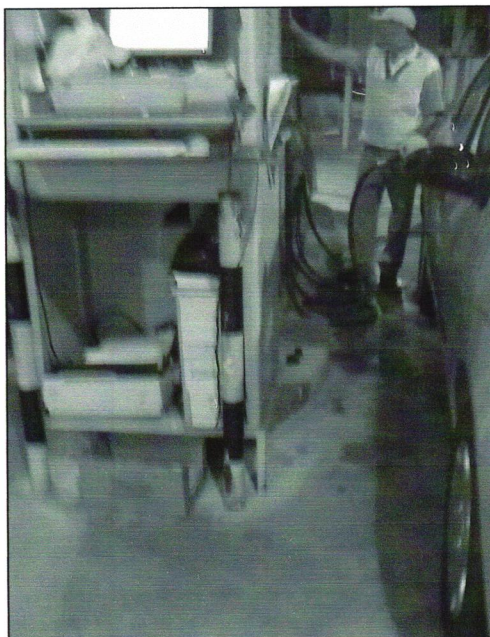
Figura 44 - Localização inadequada de equipamentos eletrônicos sem proteção em Zona 2.
