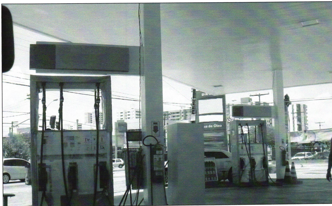
Figura 30 – Localização dos extintores PQS nas ilhas de bomba.
