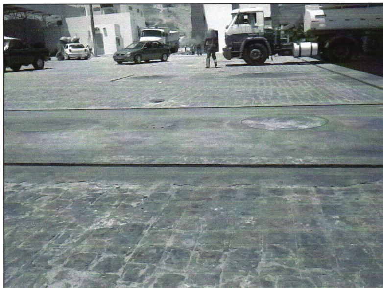
Figura 28 - Piso de posto contaminado.
