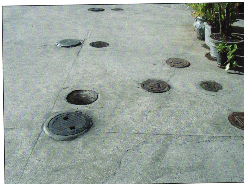
Figura 34 - Poços tamponados em posto de combustível.
