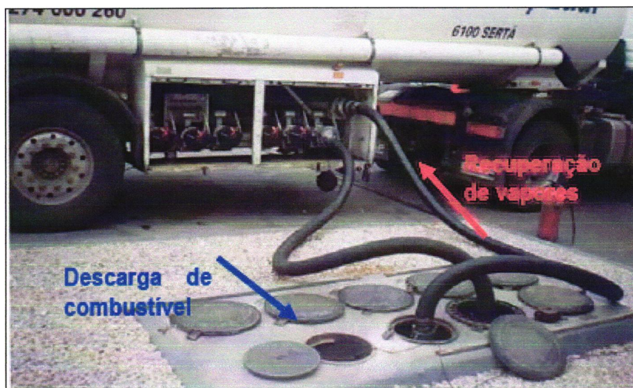
Figura 4 - Descarga do VC para os tanques de armazenamento.
