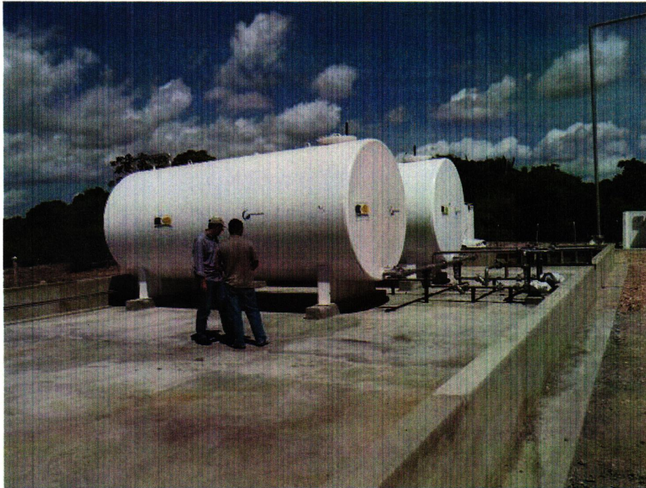
Figura 2: Tanque de armazenamento
