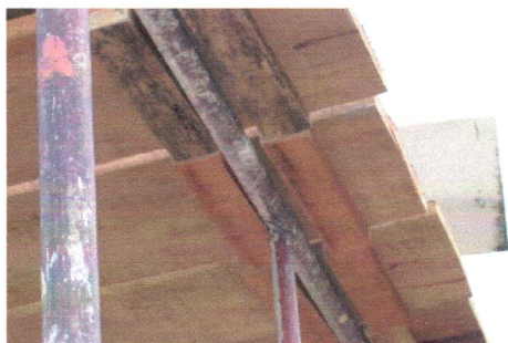
Figura 30 – Erro na montagem de Andaimes Fonte: Empresa Petrolífera, 2008
