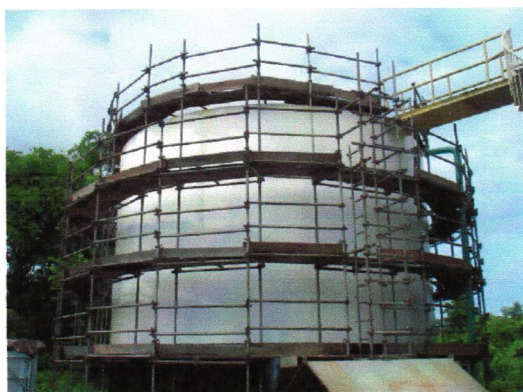
Figura 23 – Andaime em Tanque Fonte: Empresa Petrolífera, 2008
