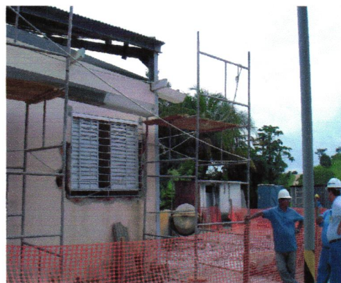
Figura 29 – Erro na montagem de Andaimes Fonte: Empresa Petrolífera, 2008
