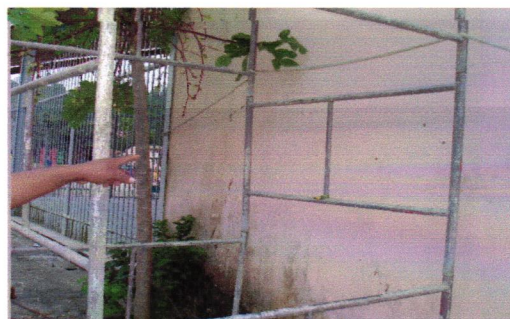
Figura 31 – Erro na montagem de Andaimes Fonte: Empresa Petrolífera, 2008
