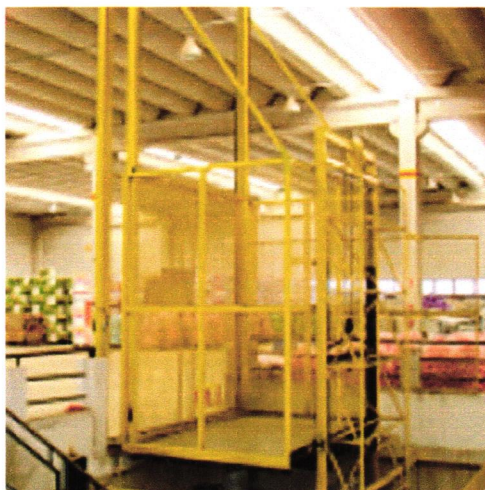
Figura 4 – Elevador de carga
