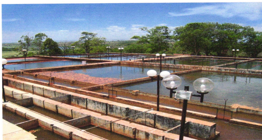
Figura 6: Decantadores da ETA Poxim.
