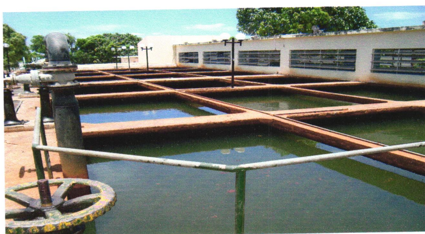
Figura 7: Filtros da ETA Poxim.
