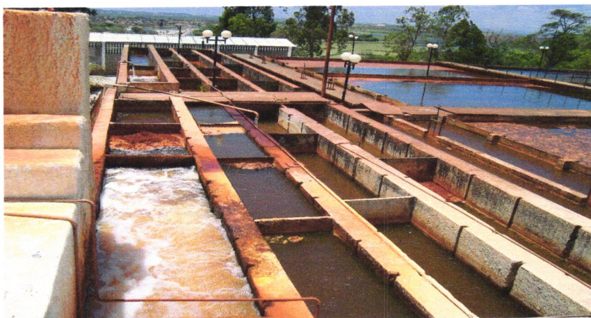
Figura 5: Floculador da ETA Poxim.
