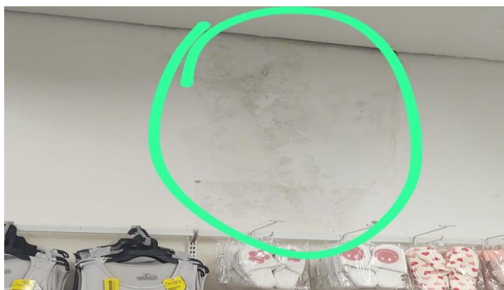
Figura 10 – Problema de Mofo
