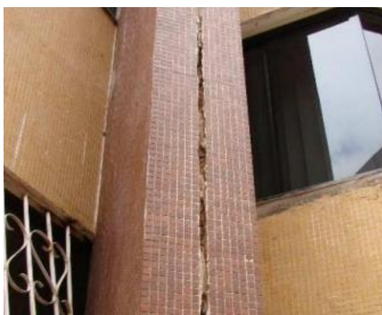
Figura 07 – Falhas nas juntas
