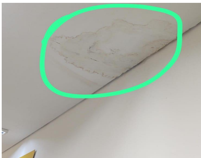
Figura 09 – Problema de umidade do tipo Infiltração
