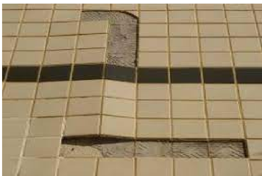
Figura 8 - Ocorrência de descolamento do revestimento.
