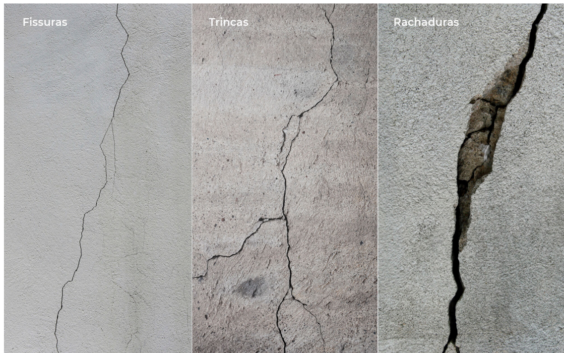
Figura 10 - Fissura, trinca e rachadura.
