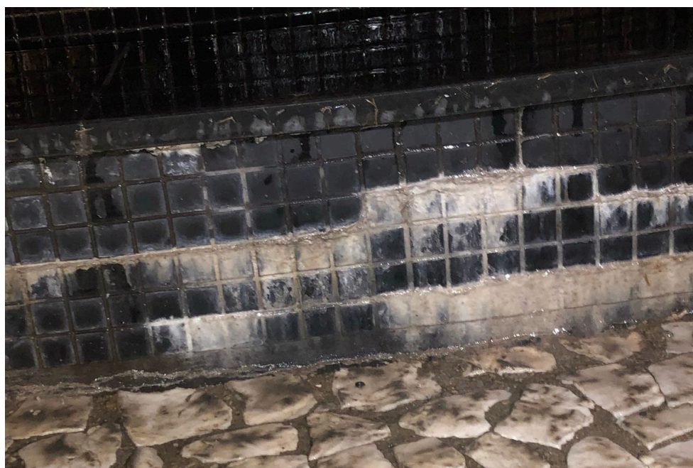
Figura 12 - Ocorrência de eflorescência.
