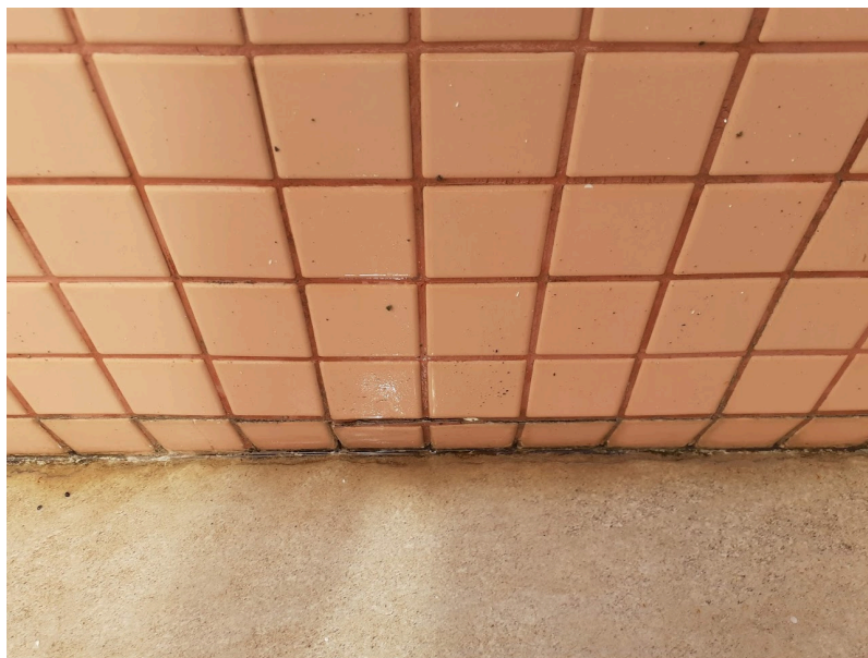
Figura 9 - Ocorrência de descolamento.
