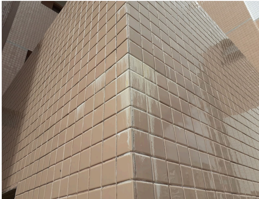
Figura 13 - Ocorrência de eflorescência.
