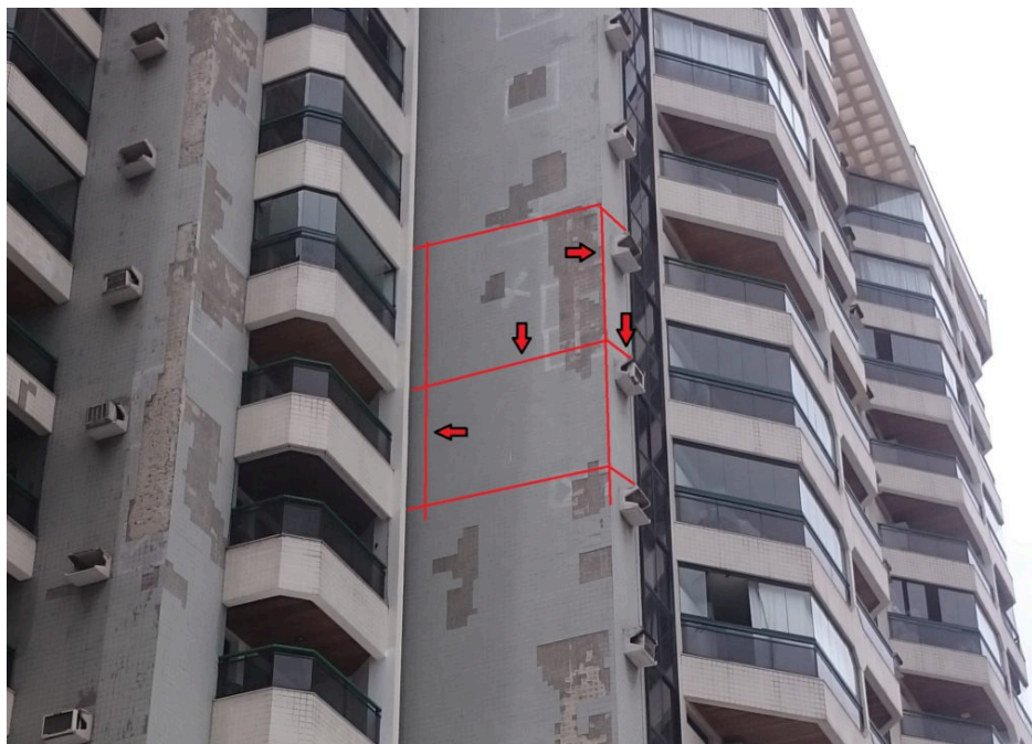
Figura 6 - Edifício com ausência de juntas de movimentação.
