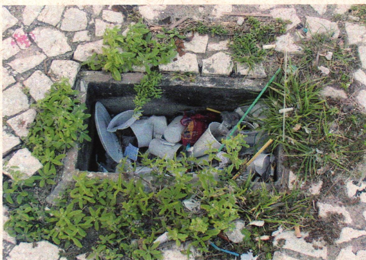
Figura 5 – Lixo acumulado na calçada de estabelecimento da Passarela do Caranguejo.
