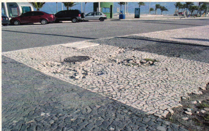
Figura 8 – Calçada deteriorada da Passarela do Caranguejo Fonte: koerber - 2007.
