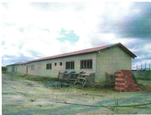
Foto 2 – Vista da casa de máquinas do matadouro. Fonte: Autor, 2009.
