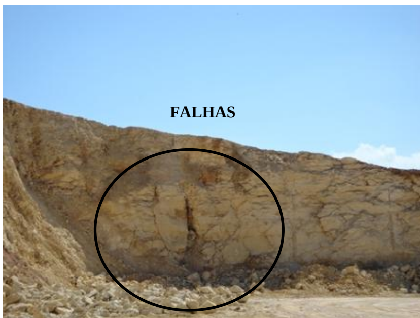
Figura 30 – Marcação entre falhas
