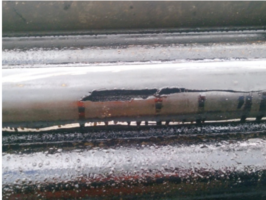
Figura 15 – Falha na tubulação de produção por abrasão interna
