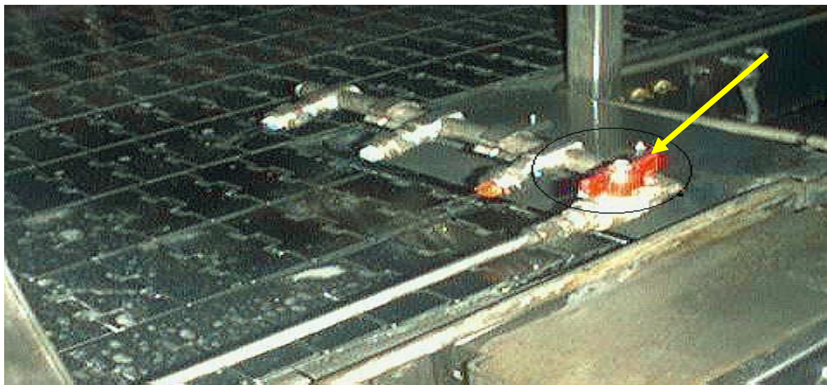
Figura 19 – Válvula de lubrificação das esteiras
