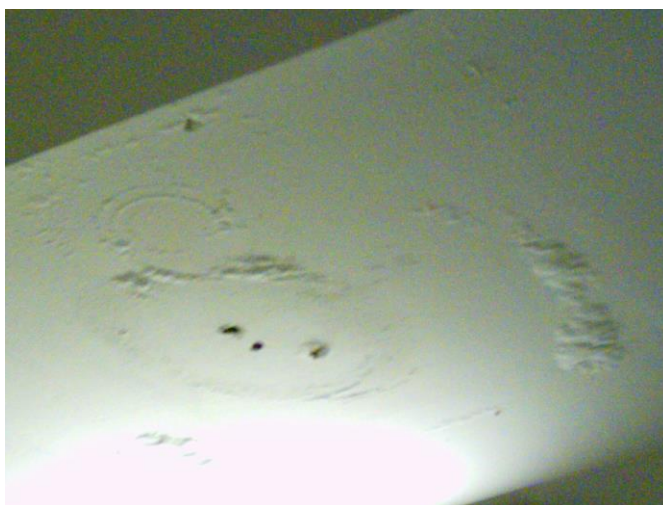
Figura 12 – Teto do setor com infiltração ao redor do ponto de iluminação.
