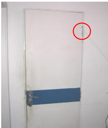
Figura 2 - Porta de entrada do setor de radiologia do H.U. - no detalhe a fiação elétrica fixada a porta
