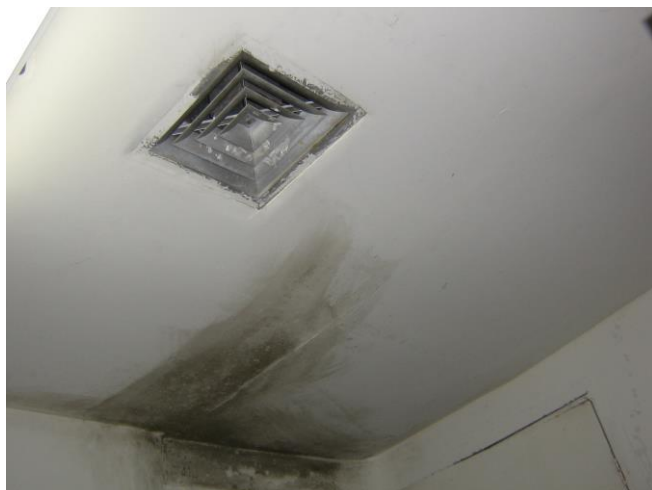
Figura 11 – Presença de mofo próximo ao duto de ventilação do setor.
