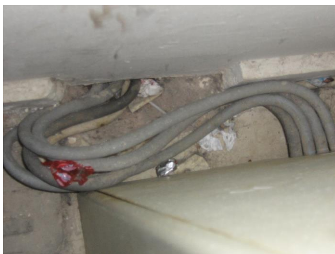
Figura 4 - Fiação do painel principal utilizado pelos técnicos.
