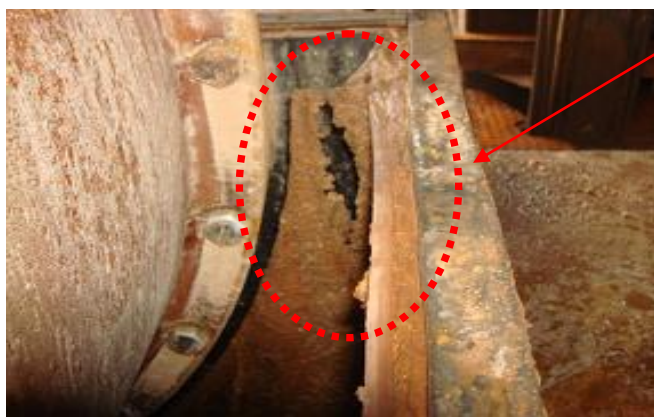
Figura 13 – Desgaste da chapa defletora
