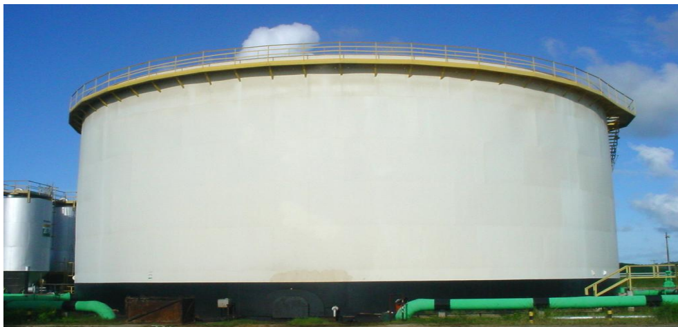
Foto 01 – Tanque de armazenamento Fonte: Autor da pesquisa
