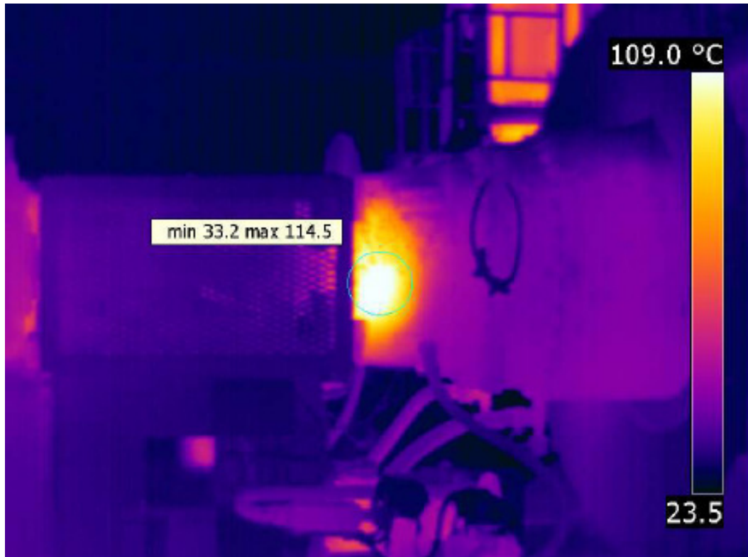
Foto 7 Imagem térmica do redutor.
