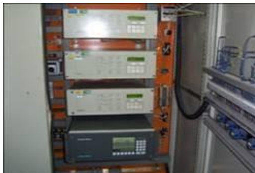
Figura 7: Analisador de gás instalado na chaminé do forno (Fonte: CIMESA, 2006).
