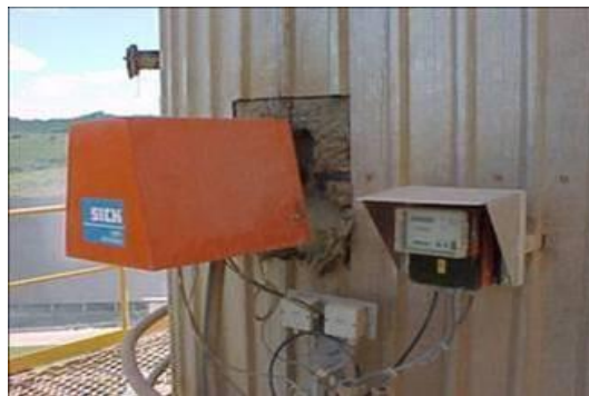
Figura 6: Opacímetro instalado na chaminé do forno (Fonte: CIMESA, 2006).
