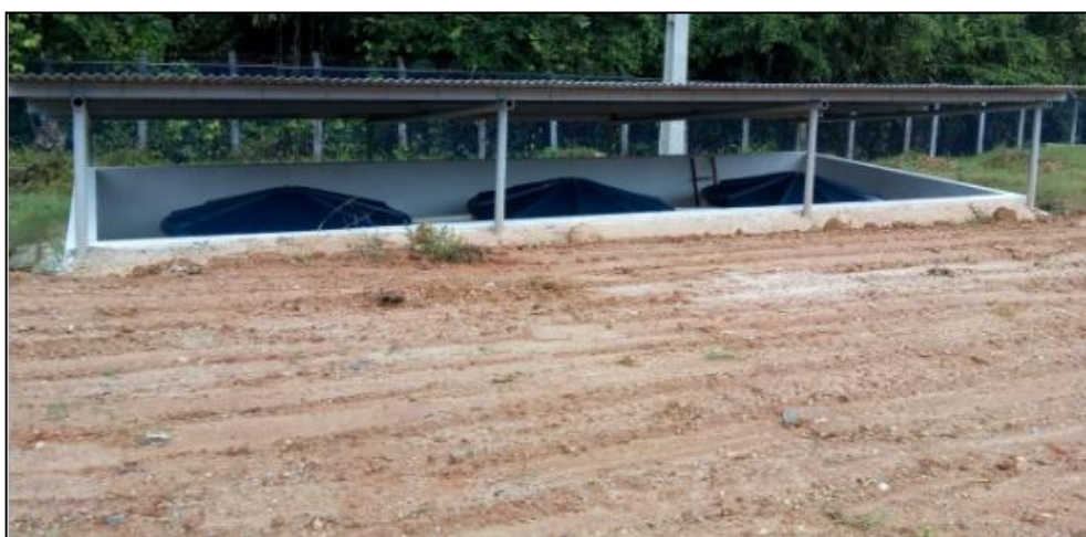
Figura 13 - Reservatórios de água para lavagem de veículos
