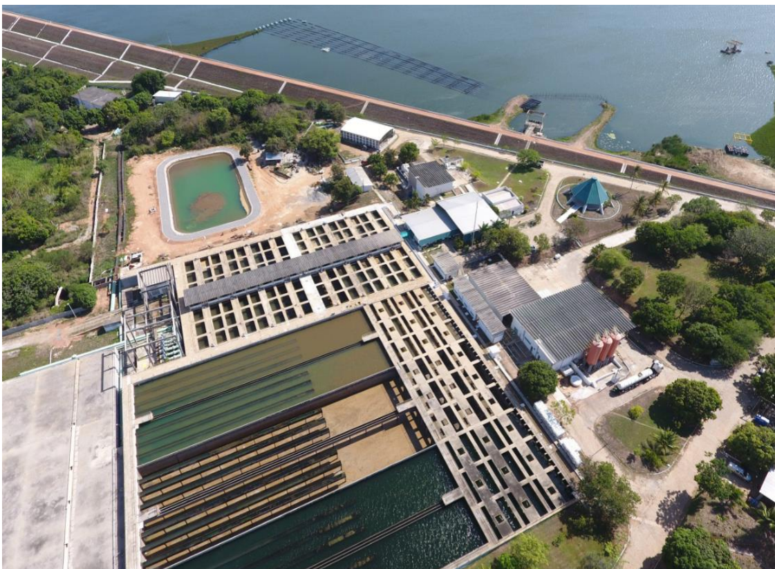
Figura 3 – sistema de captação e tratamento de água.
