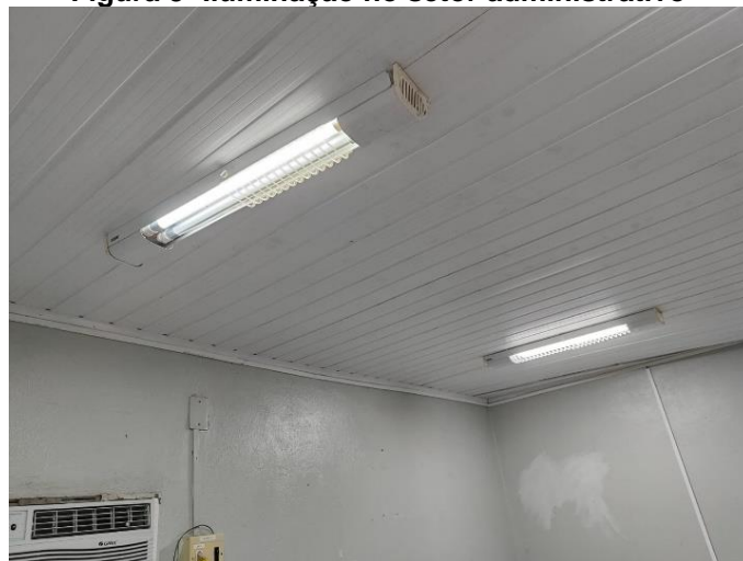
Figura 8- Iluminação no setor administrativo
