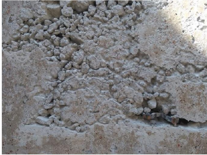
Figura 27: Segregação no concreto
