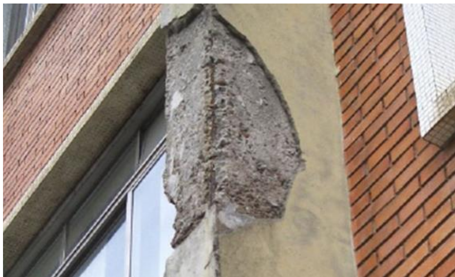
Figura 23: Deslocamento do Concreto
