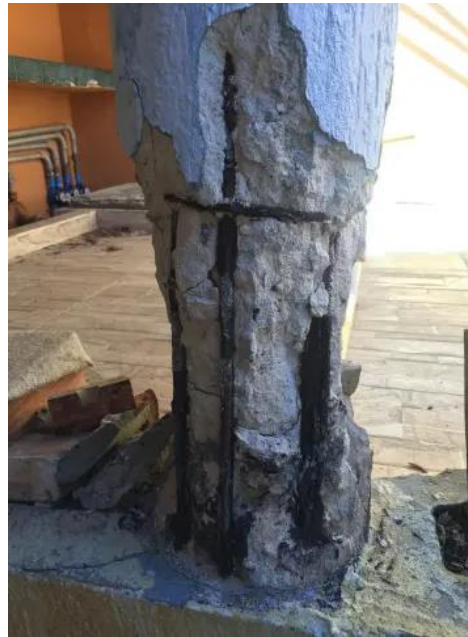
Figura 22: Armadura em estágio avançado de corrosão
