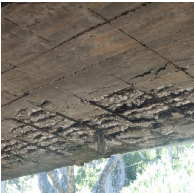
Figura 11: Perda de cobertura do concreto e armaduras em avançado estado de corrosão nas vigas longarinas.
