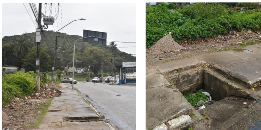
Figura 69 e 70 – Precariedade da calçada no lado leste
