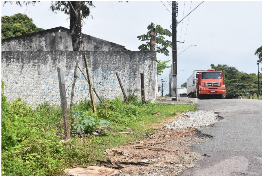
Figura 71 – Ausência de calçada na face norte
