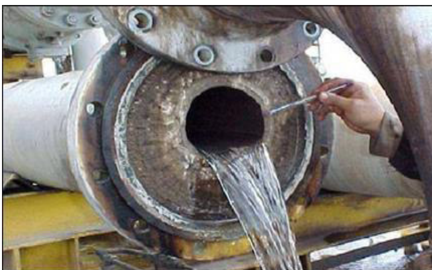
Figura 8 - Tubulação de petróleo com elevado grau de incrustação
