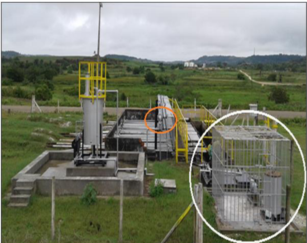
Figura 19 - Conjunto de aplicação de inibidor de químico de incrustação inorgânica (circundado em branco)
