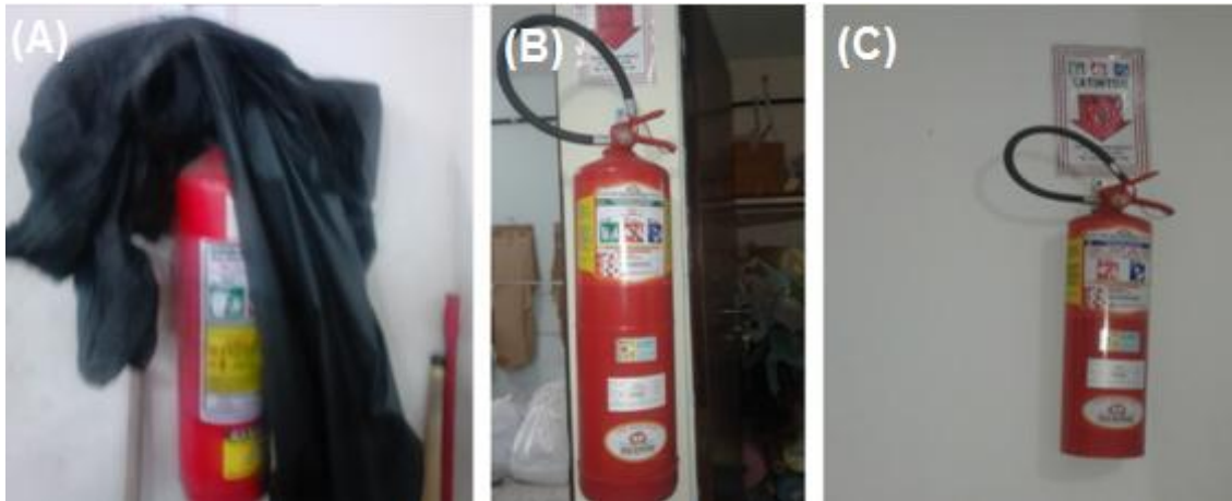
Figura 18 – Adequação de extintores
