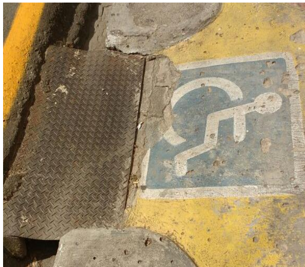
FIGURA 05 – OBSTRUÇÕES NA RAMPA DE ACESSIBILIDADE
