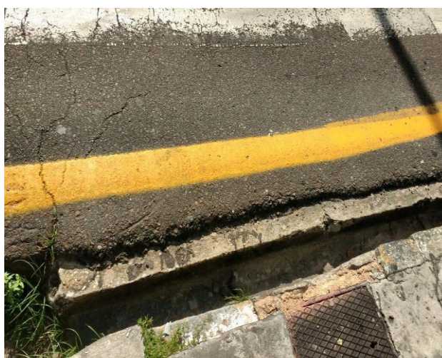
FÍGURA 10- FAIXA DE PEDESTRE INADEQUADA
