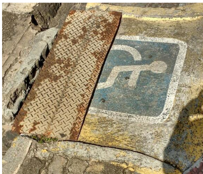
FIGURA 06 – RAMPA DE ACESSIBILIDADE COM PEÇA DE METAL DETERIORADA
