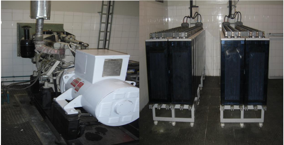
Figura 10 – Grupo motor gerador de energia e baterias
