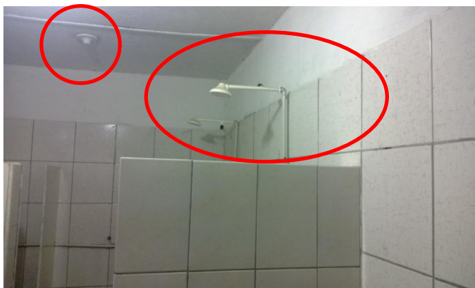
Figura 8 Iluminação e ventilação das Instalações sanitárias
