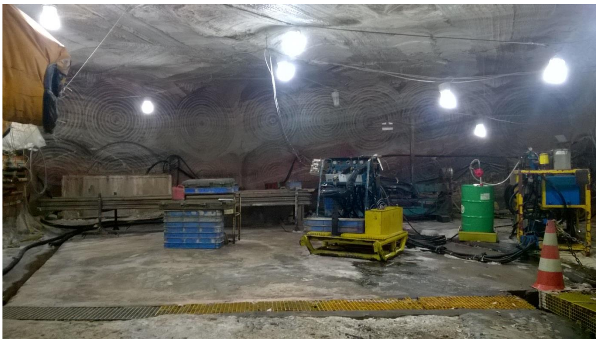
Figura 14 – Praça de sondagem com as lâmpadas de led e base de concreto no piso
