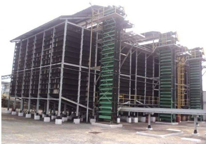
Figura 2 – Silos armazenadores de laranja
